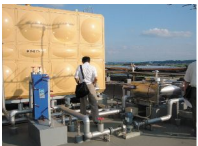
蓄熱槽、熱交換機、補給水タンク
