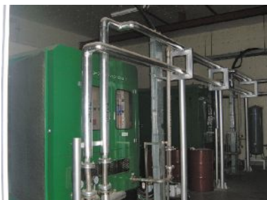
熱電併給装置(コージェネレーション)
